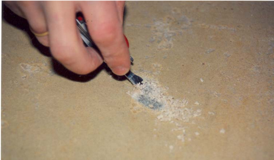
Abbildung 3: Aufgeweichtes, mechanisch leicht zu entfernendes Material aus einem geschädigten Bereich
